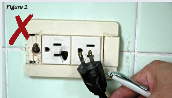
Figure 1 Une prise dont le contact à la terre est brisé. À ne pas utiliser.
