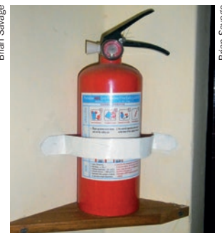
Extincteur à poudre sèche. Remarquez que l'aiguille blanche du manomètre est dans la zone verte (sûre). Faites-le vérifier une fois par an par les pompiers.
